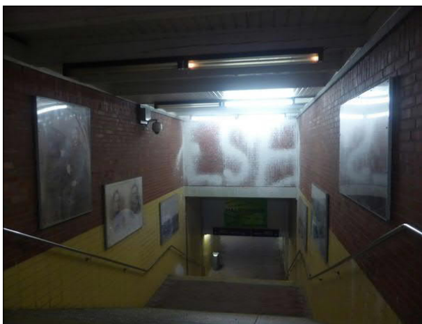
Abbildung 14: In Halstenbek funktionierte nur eine der vier Leuchten an der südlichen Bahnsteigtreppe.
