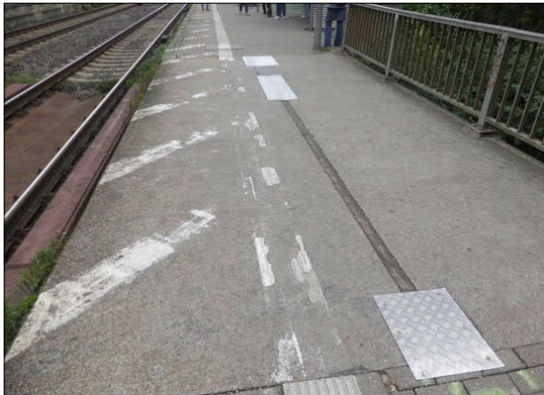
Abbildung 10: Bei allen Erhebungen im Jahr 2025 waren auf den Bahnsteigen von Elmshorn im Bereich der Brücken, nur Reste der Blindenleitstreifen vorhanden.
