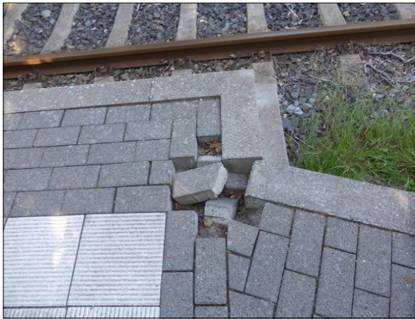
Abbildung 9: In Süderlügum wurden im August 2025 Schäden am Bahnsteig festgestellt, die auch im Dezember noch nicht repariert waren.
