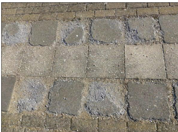
Abbildung 11: In Bredstedt sind bisher nur wenige der seit mehr als 10 Jahren stark bröckelnden Platten der Kontraststreifen auf dem Bahnsteig ausgetauscht worden.
