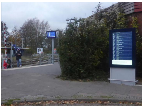
Abbildung 29: Im Herbst 2025 wurden in Eckernförde die Zugzielanzeiger erneuert. Außerdem wurden an den Bahnsteigzugängen und im Empfangsgebäude insgesamt fünf(!) neue Abfahrtsmonitore installiert.
