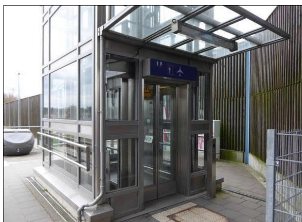
Abbildung 35: Im Aufzug an der Station Lübeck Flughafen war im 1. Quartal die Abwärtstaste defekt. Im 4. Quartal funktionierte die Aufwärtstaste nicht. Beide Male wurde weder vor Ort noch Online eine Aufzugstörung angezeigt.
