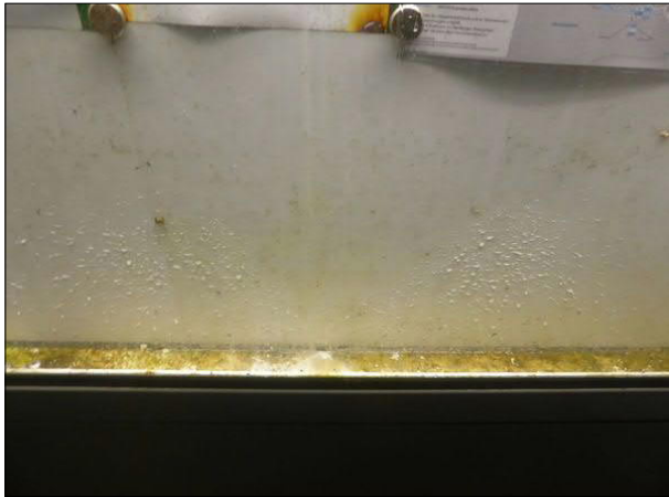
Abbildung 25: In die Vitriken in den alten Unterständen von Friedrichstadt dringt regelmäßig Wasser ein, das zur Algenbildung geführt hat.
