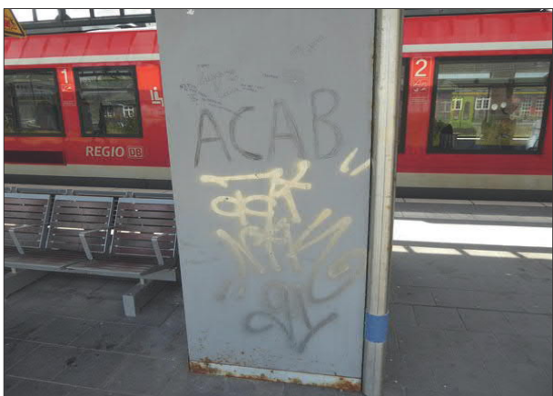
Abbildung 27: Die Snack-Automaten beeinträchtigen durch Schmierereien und Rostbildung das Erscheinungsbild an den Gleisen 4 und 5 in Flensburg.
