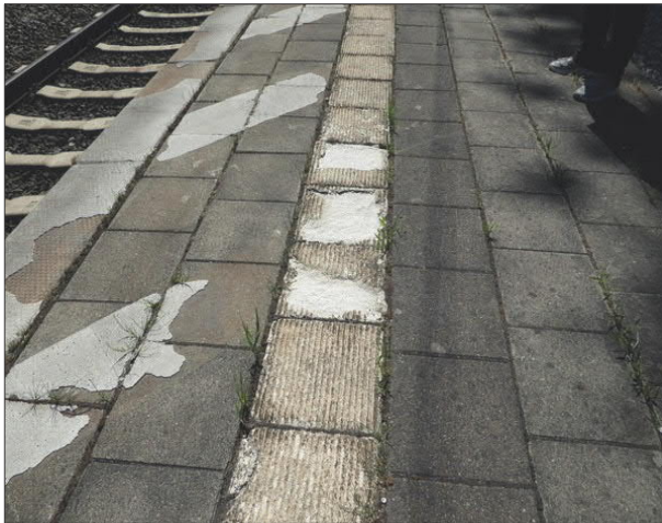
Abbildung 5: Die Platten der Blindenleitstreifen und die Gefahrenbereichsmarkierungen in Brokstedt wiesen Schäden auf.
