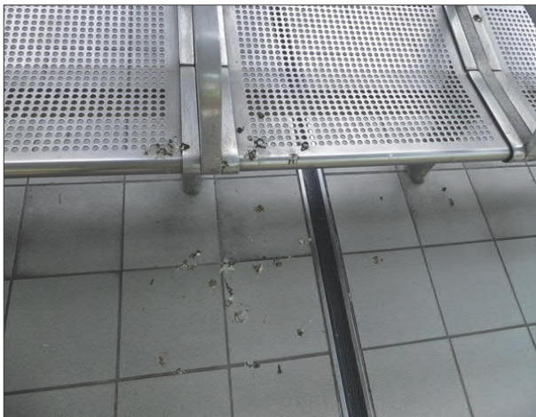
Abbildung 14: In Norderstedt Mitte waren nicht nur die Bahnsteige, sondern auch einzelne Sitze durch Taubenkot verschmutzt.
