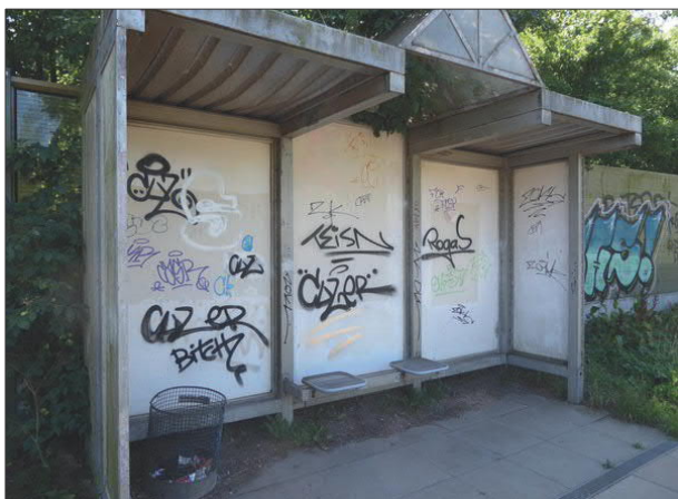
Abbildung 25: Nicht nur die Lärmschutzwände sondern auch die Unterstände des Haltepunkts Kupfermühle sind stark beschmiert. Seit der Erhebung im Winter wurden die Schmierereien nicht entfernt.
