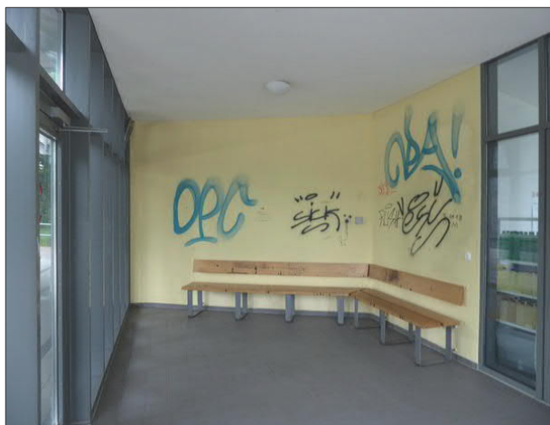
Abbildung 37: Die Wände und die Bank im Warterraum von Scharbeutz waren beschmiert und bekratzelt.
