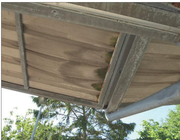
Abbildung 9: An vielen der mittlerweile rund 15 Jahre alten „Wartehallen Schleswig-Holstein“ sind die Tropfschutzfolien bereichsweise vergrünt und stellenweise abgelöst. An einigen Dächern, wie in Wesselburen, bildet sich auch Rost.
