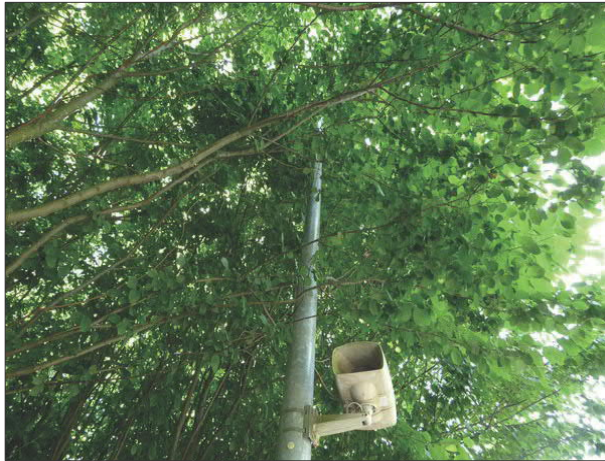
Abbildung 49: Im südlichen Bereich des Bahnsteigs in Lübeck-Kücknitz waren die Lichtmasten oberhalb von 3 m Höhe eingewachsen.
