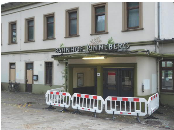
Abbildung 3: Das Bahnhofsgebäude in Pinneberg wurde am 18.5.2018 aufgrund baulicher Mängel gesperrt. Damit waren auch das Reisezentrum und die Toiletten nicht mehr zugänglich.
