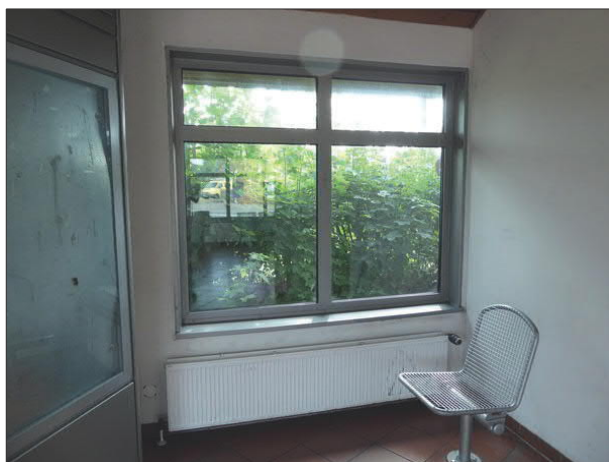
Abbildung 39: Das Fenster zur Gleisseite im Pavillon des Bahnhofs Owschlag war zugewachsen. Für die soziale Kontrolle ist das ungünstig.
