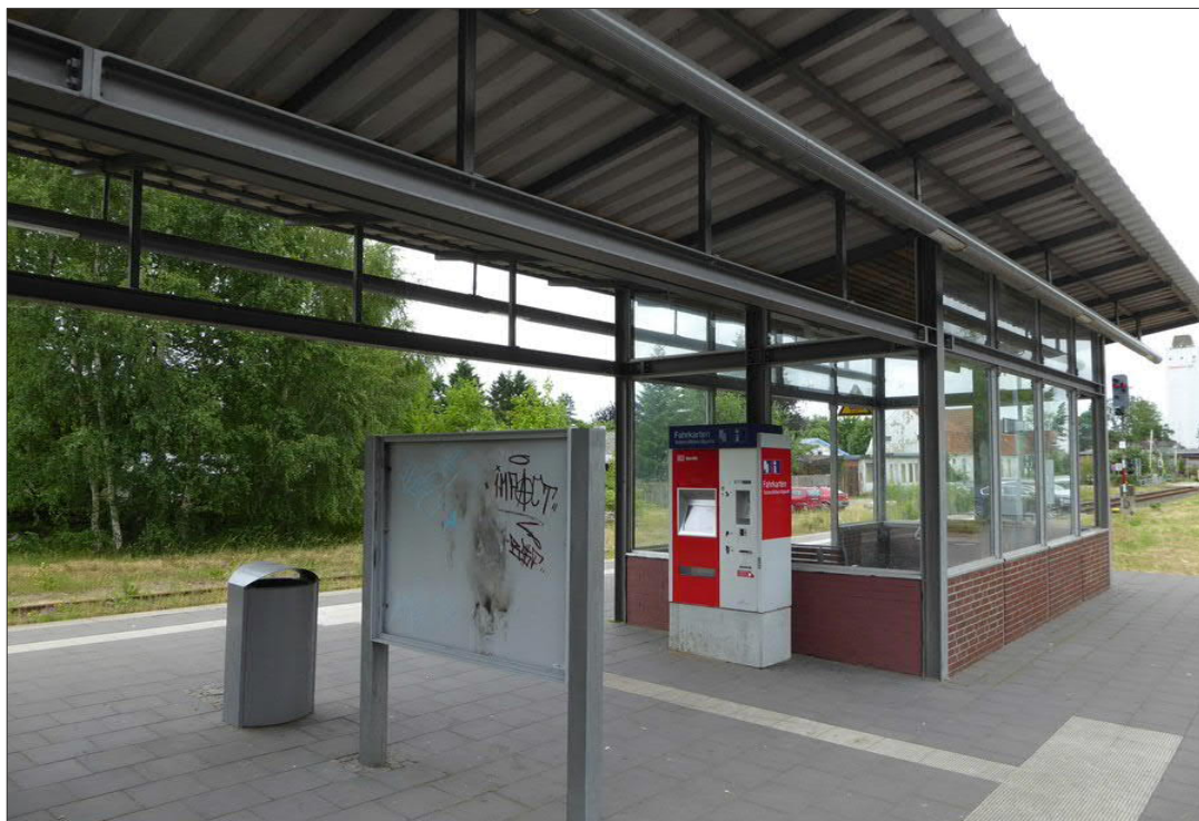
Lensahn: Haltepunkt an der Strecke Lübeck - Puttgarden. Neben den Schäden an der Wartehalle und den Vitrinen wurden auch Schmierereien und andere Verschmutzungen registriert.
