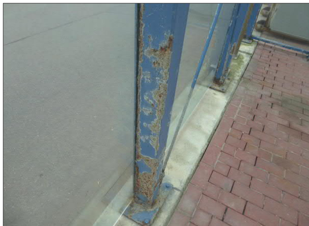
Abbildung 52: Die Stützen der Wartehalle in Dagebüll Mole weisen umfangreiche Lackschäden und Korrosion auf. Die für diesen Sommer geplante Erneuerung wurde auf das nächste Jahr verschoben.
