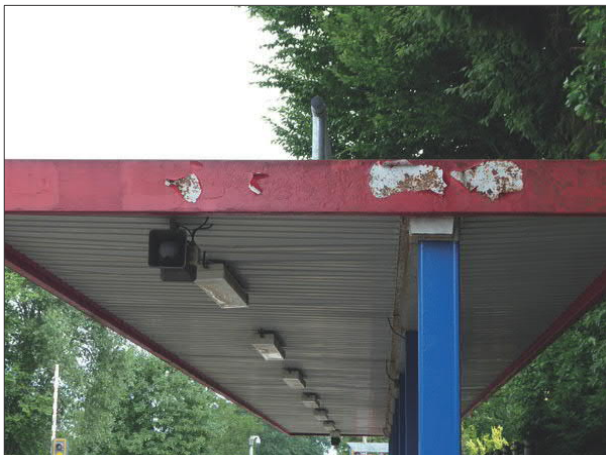
Abbildung 8: Die Bahnsteigdächer in Quickborn Süd weisen zunehmend Lackschäden mit Rostbildung auf. Sie sollen noch in diesem Jahr einen Neuanstrich erhalten.
