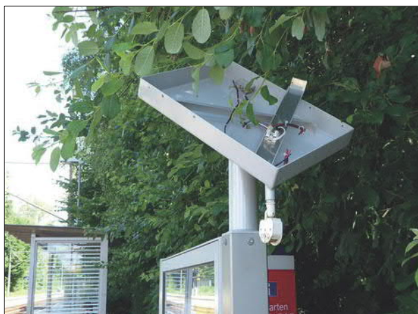
Abbildung 36: Das Solarpanel für die Stromversorgung der Beleuchtung in der Vitrine an Gleis 2 in Einfeld fehlte.
