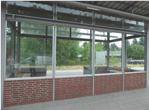
Abbildung 10: Nachdem in der Wartehalle in Lensahn im Frühjahr alle Scheiben erneuert wurden, fehlten Mitte Juni bereits wieder zwei. Zwei weitere Scheiben waren stark beschädigt.
