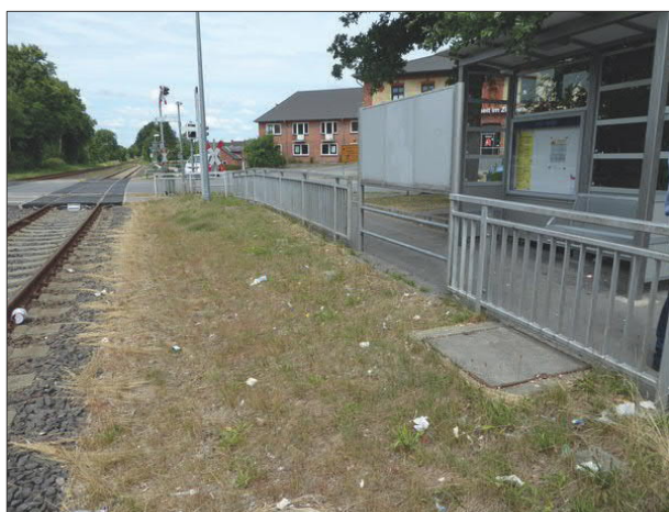
Abbildung 18: In Sörup waren die Flächen zwischen dem Geländer am Zugang und den Gleisen stark vermüllt.
