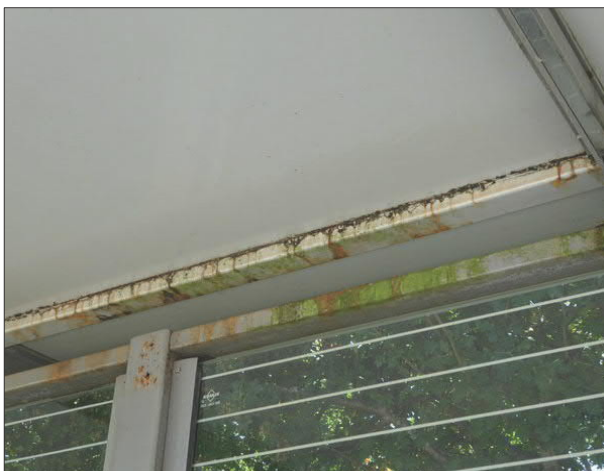
Abbildung 12: Die vergüteten Regenrinnen der Unterstände an Gleis 1 in Wrist weisen auf nach innen tropfendes Wasser durch Mängel beim Wasserablauf hin.
