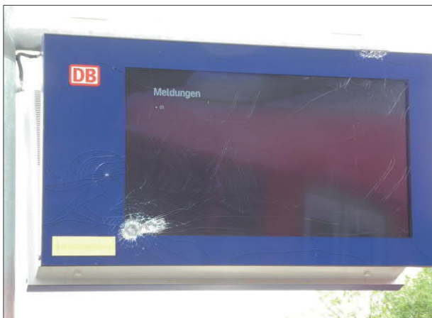
Abbildung 26: Am Zuginfo-Monitor an Gleis 3 in Eckernförde war ein Glas beschädigt, und es wurden keine Informationen zum Zugverkehr angezeigt.
