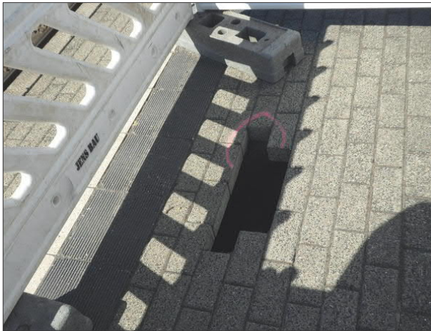
Abbildung 4: In Neumünster waren an Gleis 6 ein paar Quadratmeter des Bahnsteigs abgesperrt. Der Grund dafür war ein Hohlraum unter dem Bahnsteig. Einige Steine waren bereits verschwunden.
