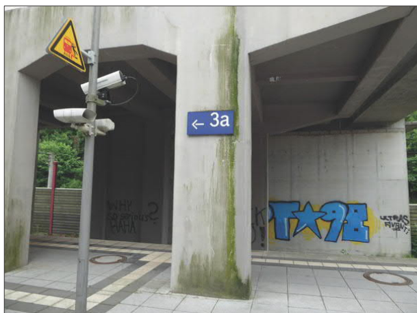
Abbildung 54: Algenbildung und Graffiti an den Stützen des Bahnhofsgebäudes und des Personenstegs beeinträchtigen das Erscheinungsbild in Aumühle.
