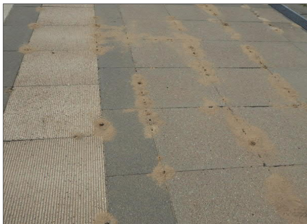
Abbildung 53: Die Fugen des Bahnsteigs Richtung Norderstedt in Friedrichsgabe wurden in diesem Sommer von vielen Insekten bewohnt.
